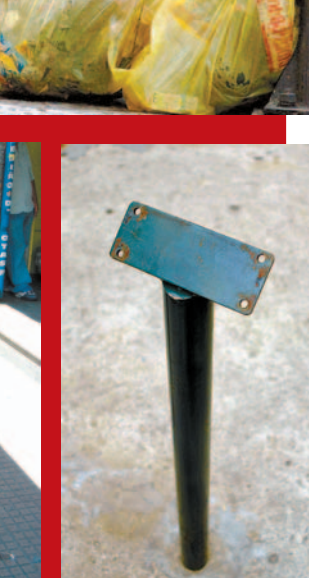
Depredação em suporte irregular
